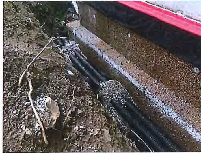
Bild 3. Dubbladningsrör runt huset
